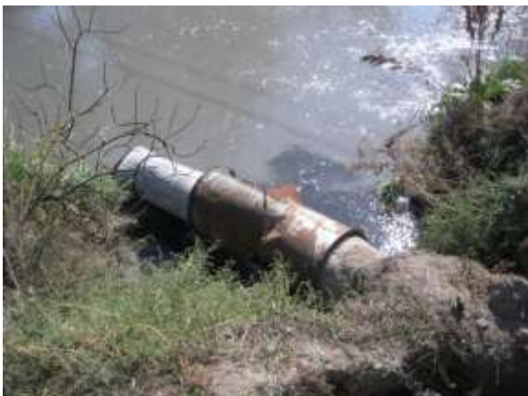
Teava de deversare a apelor tratate insuficient de la Stația de epurare s. Bulboacă, r. Anenii Noi
