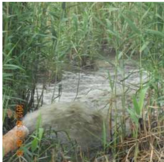
Stația de pompare Strășeni
