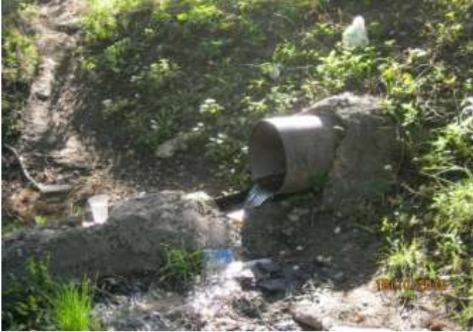
Tevi de evacuare a apelor pluviale, mun. Chișinău
